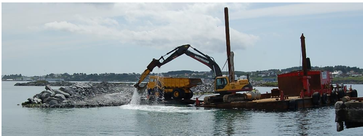
Figur 3-1: Eksempel på mudring i sjø, her vist fra flåte med langgraver. Bilde: Karmøy naturstein AS
