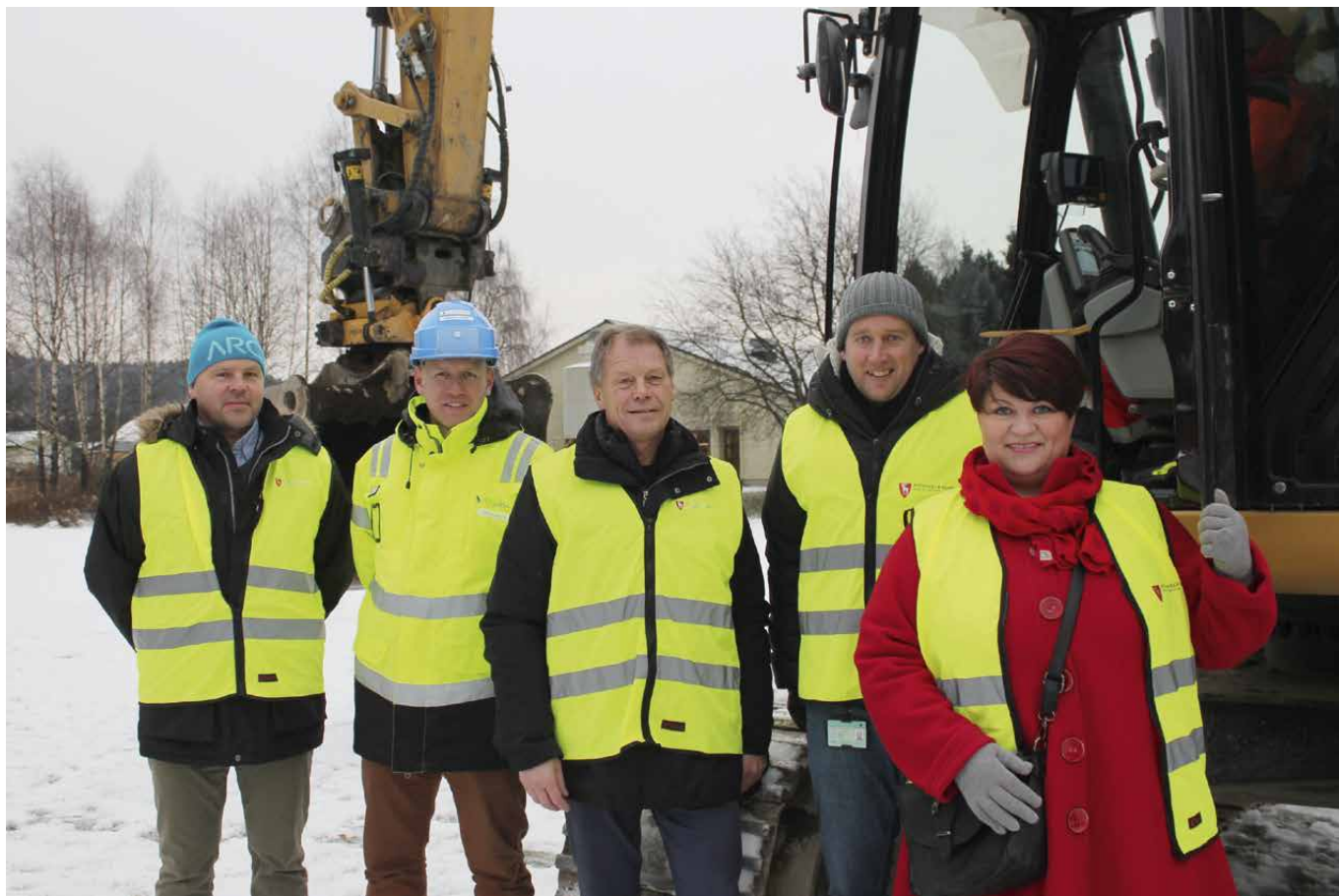
16. desember ble første spadetak tatt på Moelv skole. Skolen skal stå ferdig høsten 2017.
